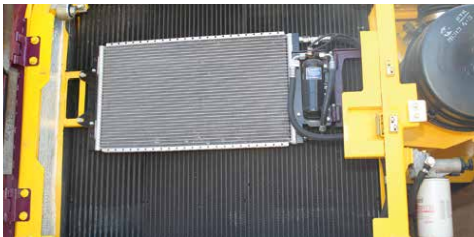
▲ На снимке: блок радиаторов, радиатор кондиционера, воздушный фильтр и топливный фильтр грубой очистки
